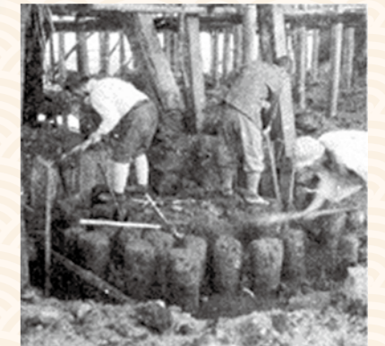
这张是正在进行柱下的基础工程时的照片，从中能够看到松木桩的顶部。 本照片借自《国宝及重要文化财产建造物严岛神社昭和修理综合报告书》。
